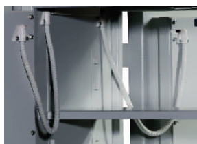
Türsteuerung reguliert die Freigabe des jeweiligen Motorblocks in Innen- und Aussentür
